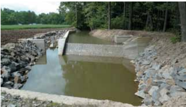
Zrekonstruovaný jez na obnoveném toku Bílovky v CHKO Poodří s odběrem vody do rybníků a novým rybochodem. (Investor: Povodí Odry, s. p., foto Vilém Řiháček)
